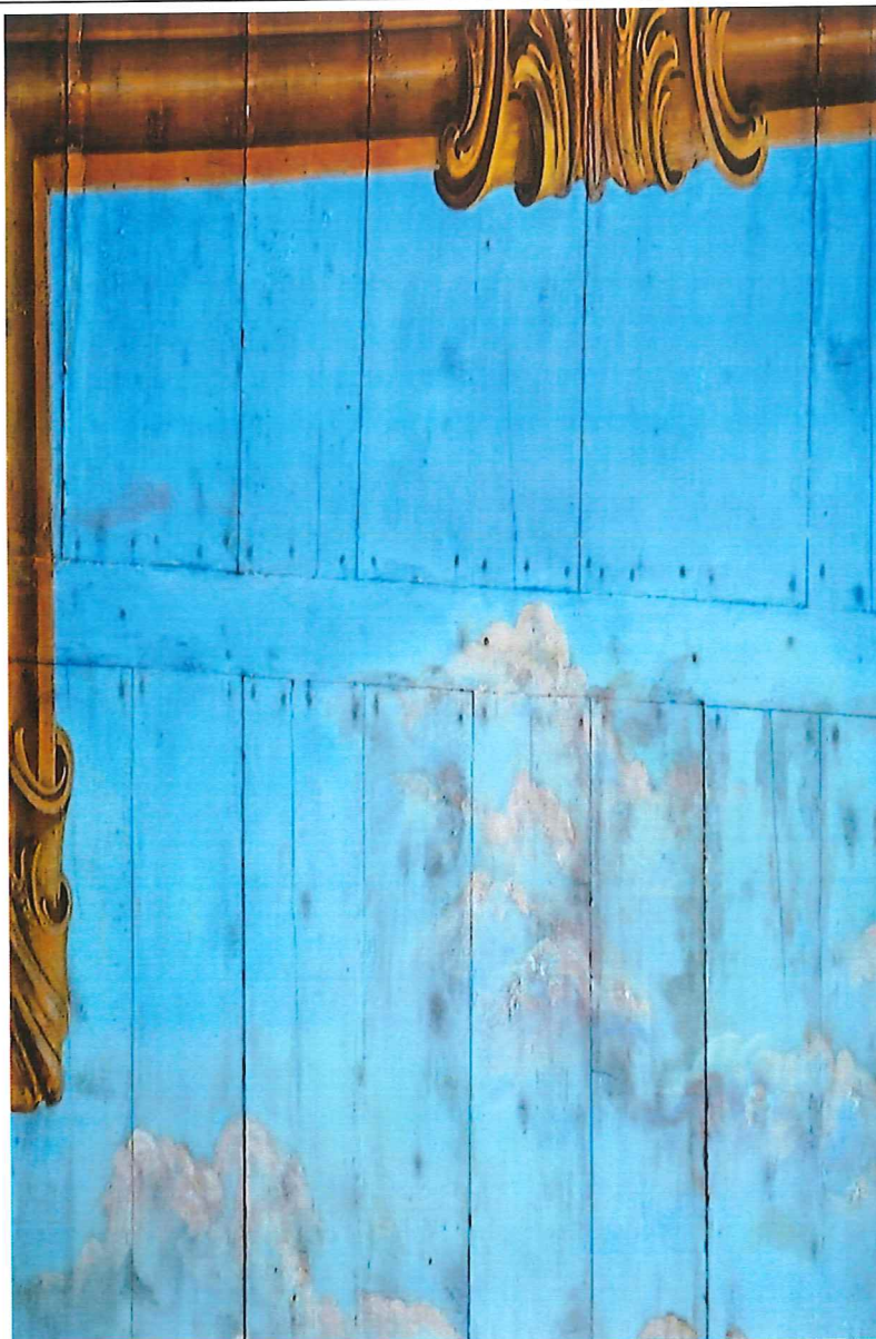
Fot.2 Fragment polichromii na drewnianym stropie nawy widoczne zaplamienia, rozszczelnienia na łączeniu desek oraz skorodowane gwoździe – stan zachowania przed konserwacją.
